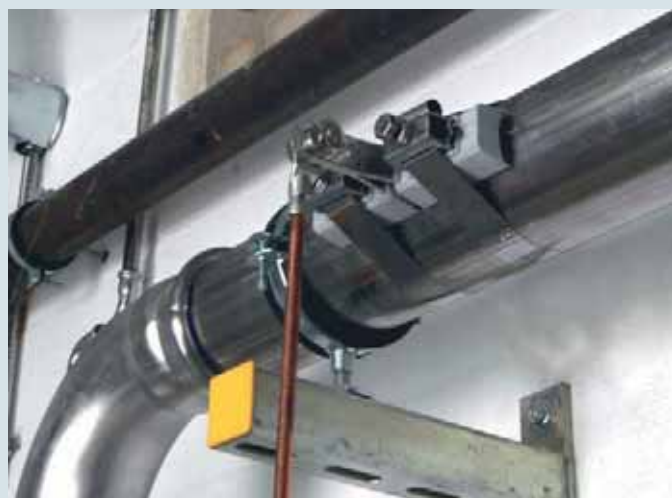
Aplicación en una tubería de NIRO
