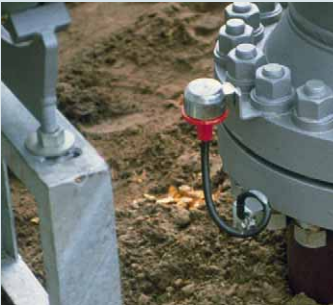
Vía de chispas de separación homologada por ATEX para la compensación de potencial de protección contra el rayo según DIN V VDE V 0185 con conexión flexible de conductores.
