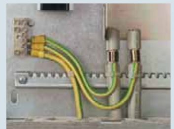
Conexión del blindaje con SA KRF.
